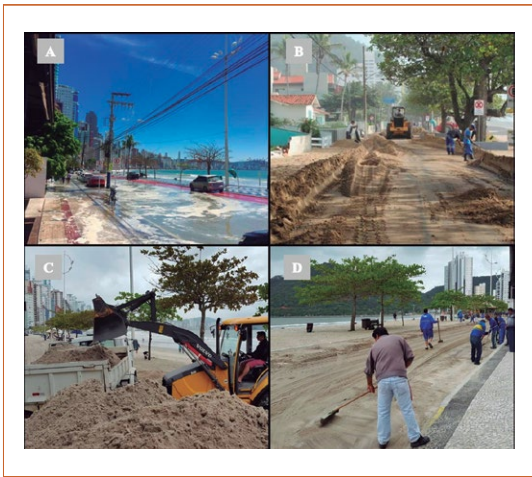
Figura 7.40 A - Mar invadiu a Avenida Atlântica em Balneário Camboriú. Foto: Marco Moreira. B - Areia depositada sobre a Avenida Atlântica. Foto: Virgínia Cardoso/Secretária de obras. C - Remoção da areia com auxílio de caçambas e retroescavadeiras. Foto: Luiz Carlos Souza/RBS TV. D - Operários removeram areia Avenida Atlântica. Foto: Luiz Carlos Souza/RBS TV.
